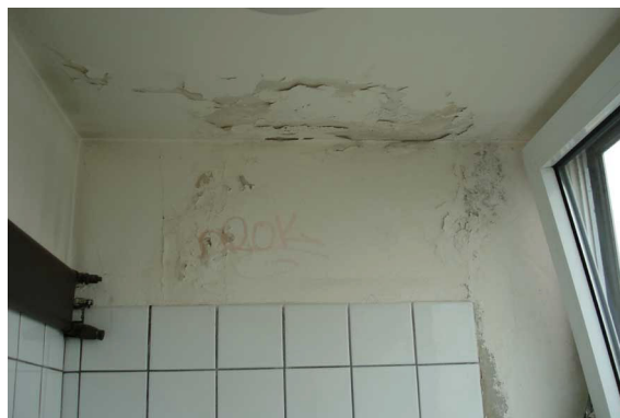
Foto: Feuchtigkeitsschäden, WC-Anlage K-Trakt
