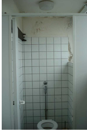
Foto: Feuchtigkeitsschäden, WC-Anlage K-Trakt
